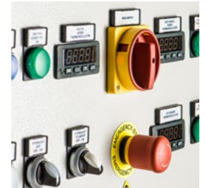
3. Strumenti di controllo del riscaldamento materiali
